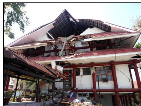
Gambar 7. Kondisi Salah Satu Bangunan Universitas Tadulako
